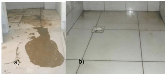
Figura 5. Caimento inadequado em piso cerâmico em boxes de banheiros.
