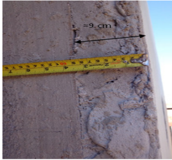
Figura 4. Emboço em parede de alvenaria em desaprumo.
