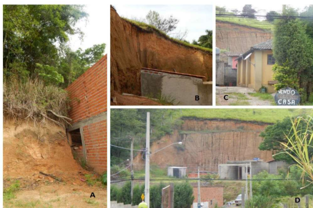
Figura 10 - Pontos do bairro de estudo onde se encontram taludes de cortes efetuados sem critérios técnicos. Foto: CAROU, C. B. (2013).
