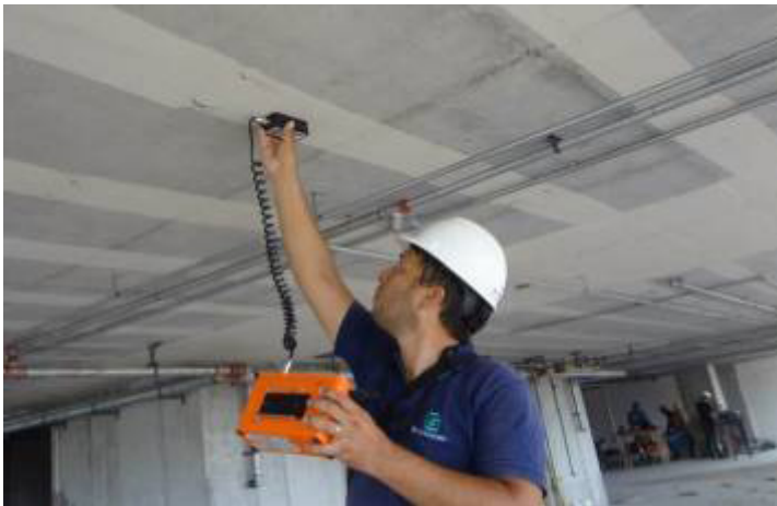
Figura 3 – Ubicación de armaduras con detector electromagnético.
