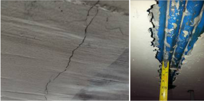
Figuras 28 y 29. Fisuras y cabos expuestos en la losa.
