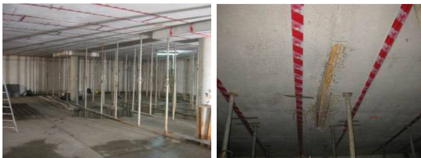
Figuras 17 y 18 – Vista del sector de estudio y desprendimientos.
