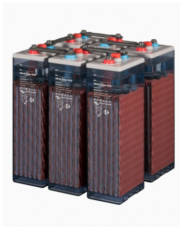
Figura 3 – Foto de um banco de 12V formado por de 6 baterias de 2V do tipo OPzS
