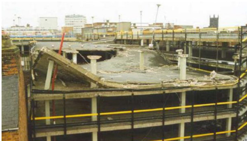
Figura 1 - Colapso parcial do edifício Pipers Row Multi-Storey Car Park .
