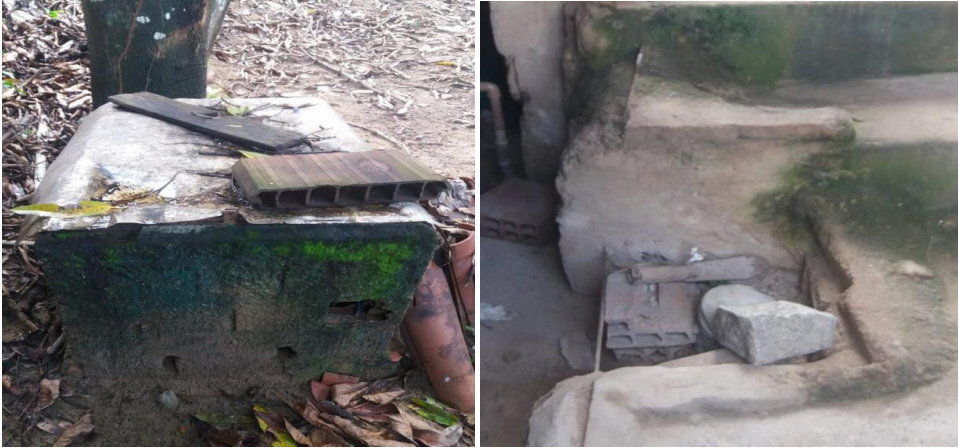
Figuras 5 e 6. Estruturas Inadequadas das Caixas de Bomba para os poços. Fonte: Os Autores (2020).
