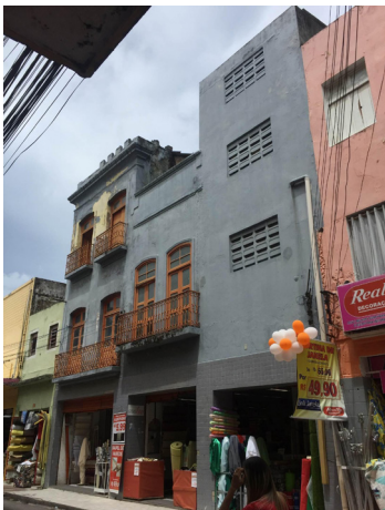
Figura 07. Modificação das fachadas dos móveis 219, 225 e descaracterização do imóvel 229 da Rua Direita, com interligação dos três imóveis.
