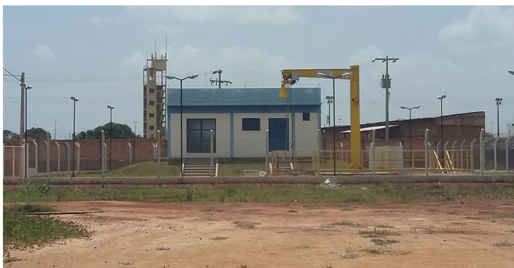
Figura 04: Estação Elevatória de Esgoto (EEE) do Bairro Pricumã. Fonte: Arquivo da Empresa Renovo Engenharia Ltda.
