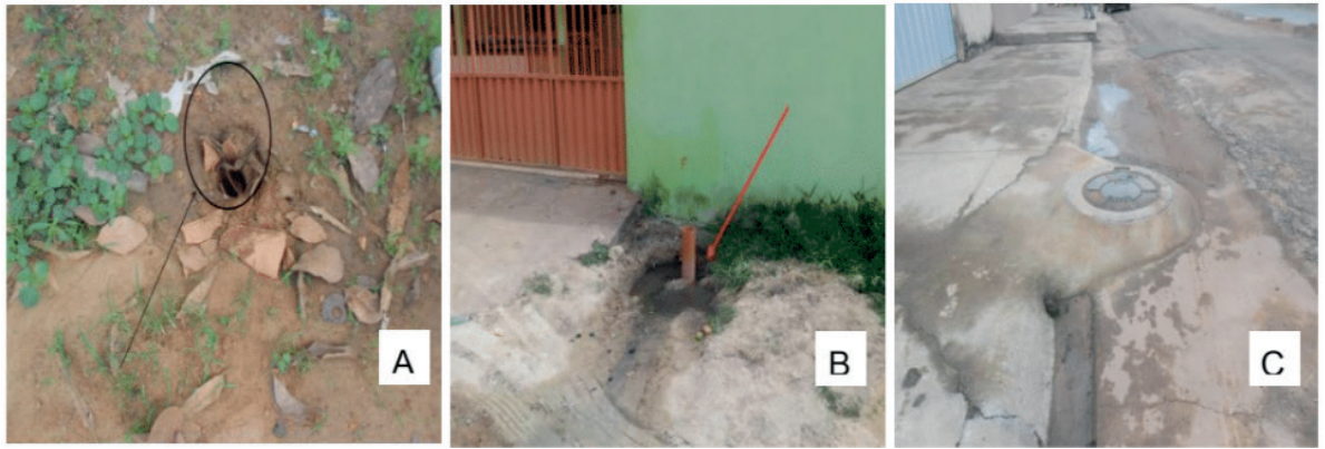
Figura 07: A - Ligação Domiciliar sem tampa, servindo de drenagem de águas pluviais. B - ligação com vazamento de esgoto – provável ligação clandestina. C- Vala mal compactada, causando recalque e posteriormente afundamento do pavimento e calçada.
