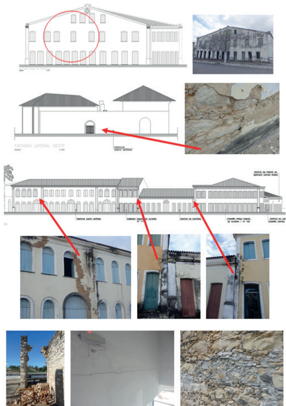
Figura 4- (acima): Fachada da Biblioteca (Casarão do Oitão) e vista geral do estado de conservação atual; (centro): Fachada lateral esquerda do campus e degradações com perda do reboco e Fachada principal do Campus de Laranjeiras e degradações das mais variadas; (abaixo): Queda de um dos arcos em abril de 2017, Fissuras no Casarão 159, Uso de cimento para preenchimento de lacunas nas paredes de pedra.
