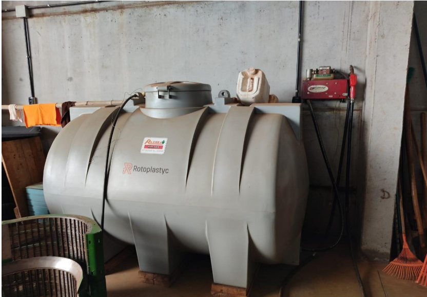
Figura 5: Tanque de armazenamento de combustível dentro da instalação.
