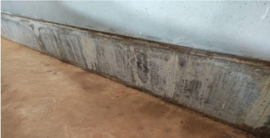
Figura 1: infiltrações de água, impossibilitando armazenar sementes e afins próximo a parede.
