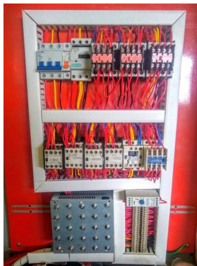
Figura 6: Estrutura interna do quadro.
