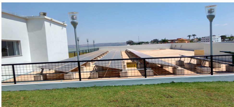
Figura 3 - Micro usina fotovoltaica UNIPAM
