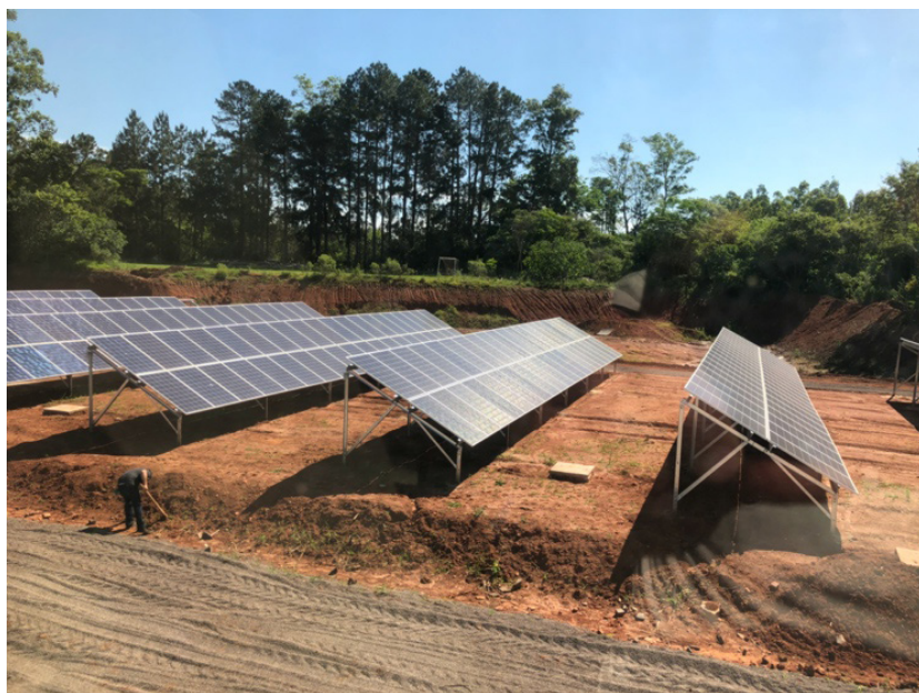
Figura 3 - Planta de minigeração solar fotovoltaica da UFSM
