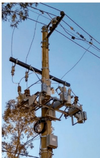
Figura 7 - Banco de Capacitores instalado na UFSM
