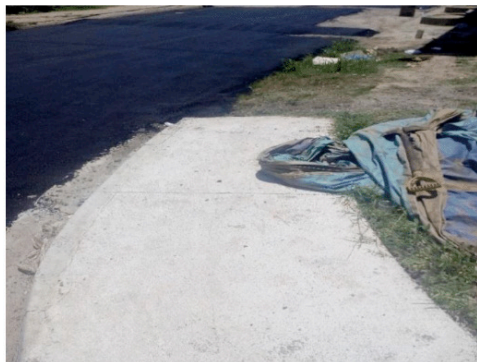
Fig 2: Calçadas obstruídas ou inacabadas
