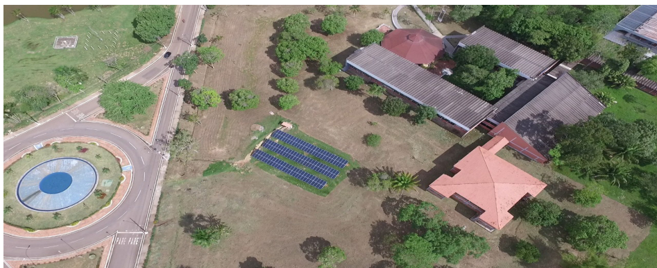
Figura 1: Gerador de 60,59 kWp, localizado nas intermediações da biblioteca central da universidade.
