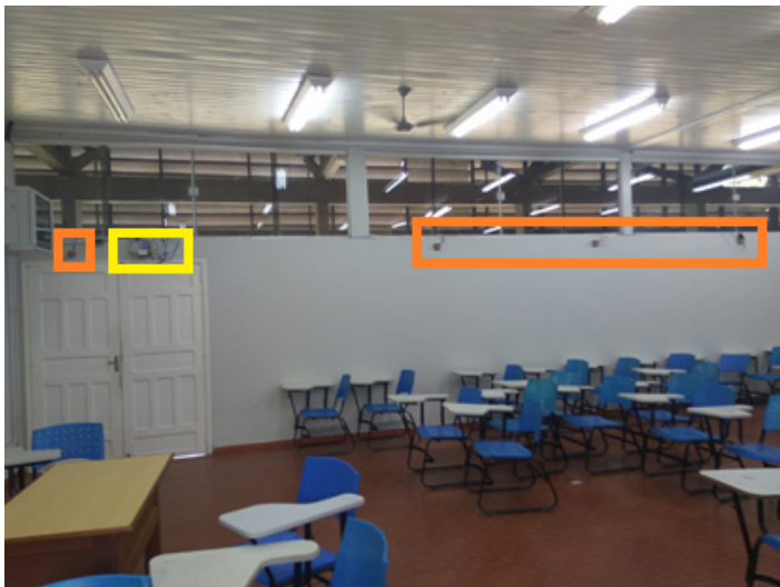
Figura 6: Instalação do protótipo em sala aula. Em laranja os sensores de presença do tipo PI, em amarelo o protótipo de automação.
