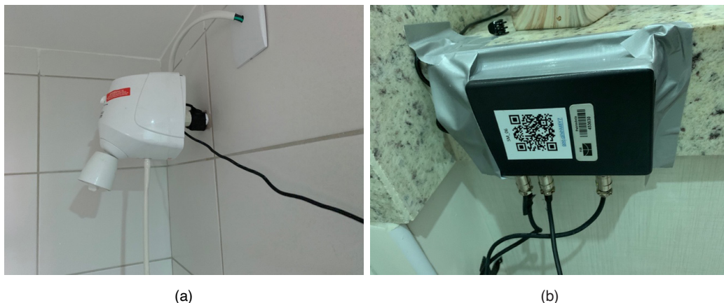
Figura 2. Medidor de fluxo (a) instalado no chuveiro, conectado ao datalogger (b).
