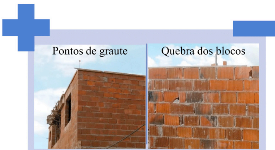
Figura 01: Acertos e erros nas obras
