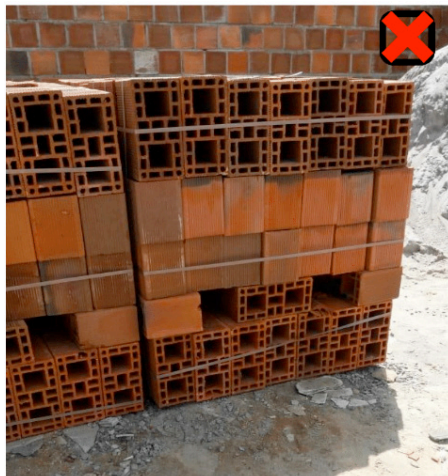
Figura 07: Armazenamento inadequado de materiais
