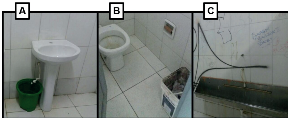
Figura 2: Má estrutura oferecida pelos banheiros da escola.
