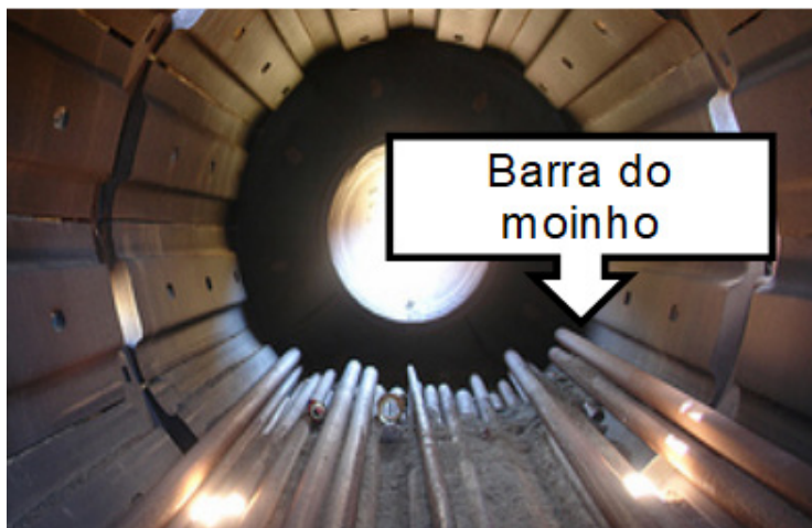
Figura 1: Unidade de processamento de um moinho de Barras
