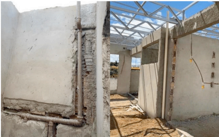
Figura 4 e 5 - Incompatibilidade entre estrutural e água fria e Incompatibilidade entre estrutural e esgoto sanitário.
