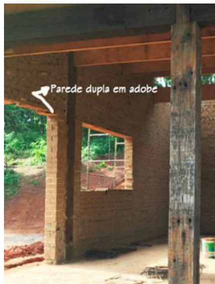
Figura 7 - Duplicidade do adobe na parede externa na edificação unifamiliar (crédito: M Marques, 2017)
