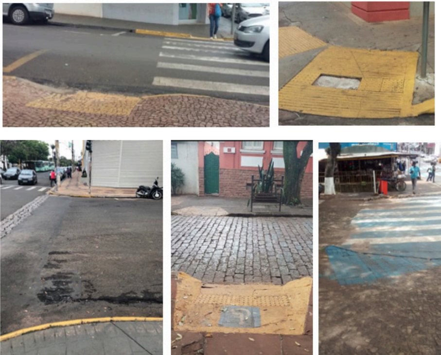
Figura 6: Acima: Rebaixamento de guia desalinhado com a faixa de travessia, com piso irregular, e danificado. À esquerda: Matão (ausência de rebaixamento de guia e faixa de travessia). Ao centro: Araraquara (desalinhamento de guias / descontinuidade no trajeto / leito carroçável com piso irregular). À direita: São Carlos (rebaixamento irregular, desnível junto à sarjeta, elementos táteis sem contraste visual instalados em desacordo com ABNT, pintura da faixa desgastada, guia danificada com ausência de rebaixamento no lado oposto e acúmulo de elementos como lixeiras, bicicletas e barracas de comércio). Fotos das autoras.
