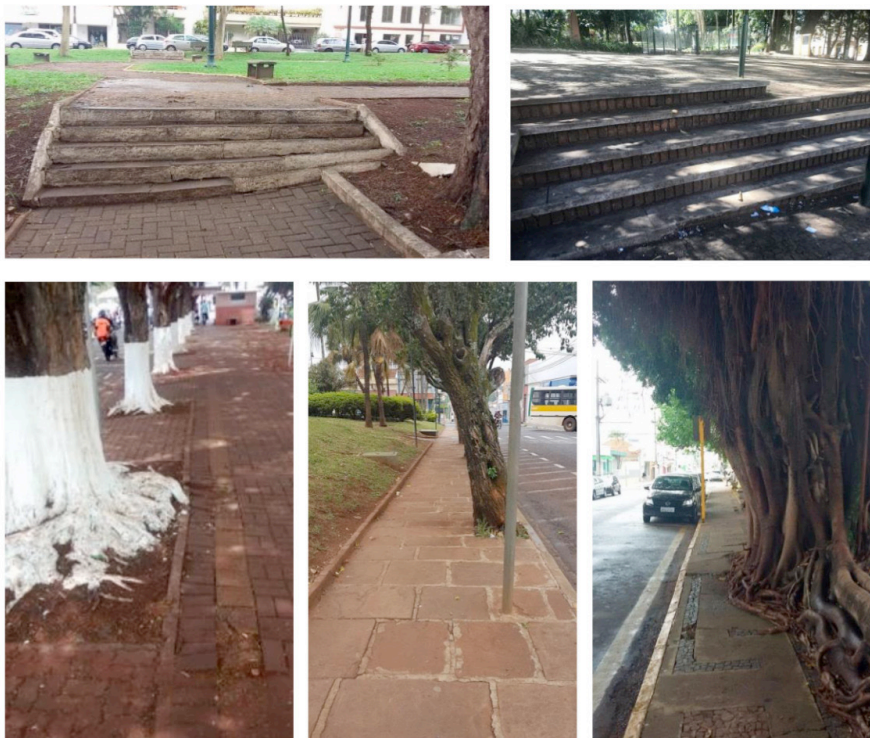
Figura 8: Acima à esquerda: Jaboticabal: escada executada de maneira irregular, sem corrimão, sem sinalização, ausência de rota alternativa acessível. Acima à direita: São Carlos: escada com interrupção nos degraus, sem corrimão e sem sinalização. Embaixo à esquerda: São Carlos (raízes invasivas, piso danificado e implantação irregular de sinalização tátil). Ao centro: Araraquara e à direita: Jaboticabal: ambas com obstrução da largura da faixa de circulação por espécies arbóreas inadequadas para calçadas. Fotos das autoras.
