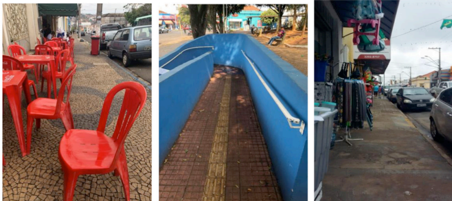
Figura 10: À esquerda Matão: Obstrução de áreas de circulação / apropriação indevida do espaço público para fins privados. Ao centro Matão: Rampa executada em área pública: interrupção no corrimão, alturas, empunhadura e tipologia incorretas, piso trepidante, instalação indevida e desnecessária de elemento tátil direcional sobre a rampa. À direita: Jaboticabal: Uso do espaço público para fins privados, invasão da faixa livre de circulação no solo e aérea, piso irregular e sem sinalização. Fotos das autoras.
