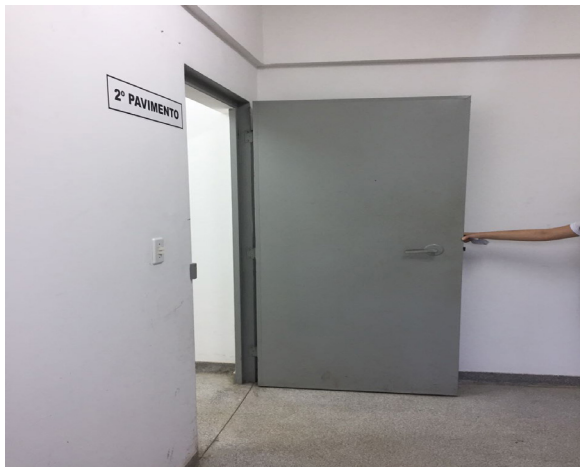
Figura 10 – Falta de contraste nas portas da escada de emergência
