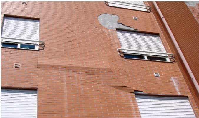
Figura 2 – Perda de aderência no revestimento da fachada de prédio.
