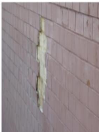
Figura 3 – Descolamento com empolamento de um grupo de ladrilhos em paredes exteriores
