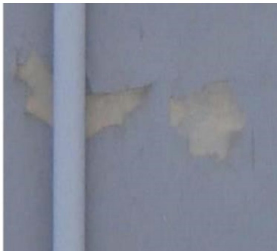
Figura 6 – Descascamento da tinta em revestimento de pintura.
