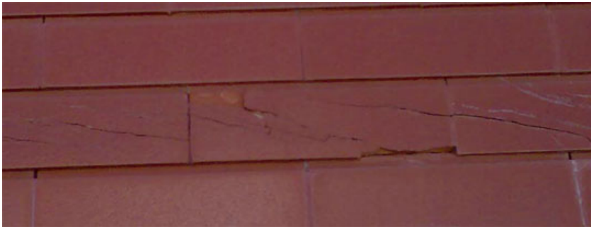
Figura 4 – Fissura na placa cerâmica do revestimento em parede externa.
