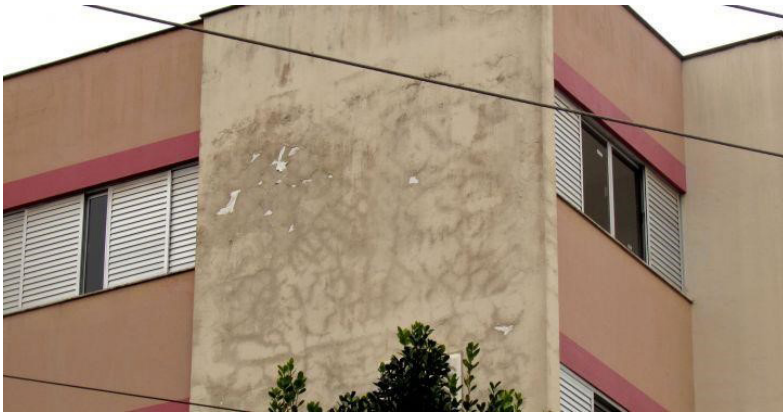
Figura 1 – Caso de fissura em revestimento argamassado.
