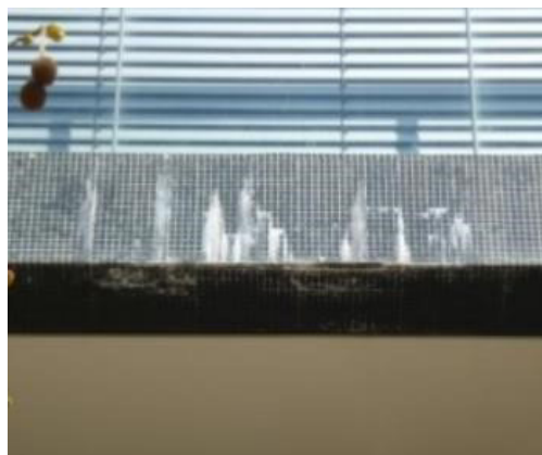
Figura 5 – Manchas esbranquiçadas em fachada de prédio.
