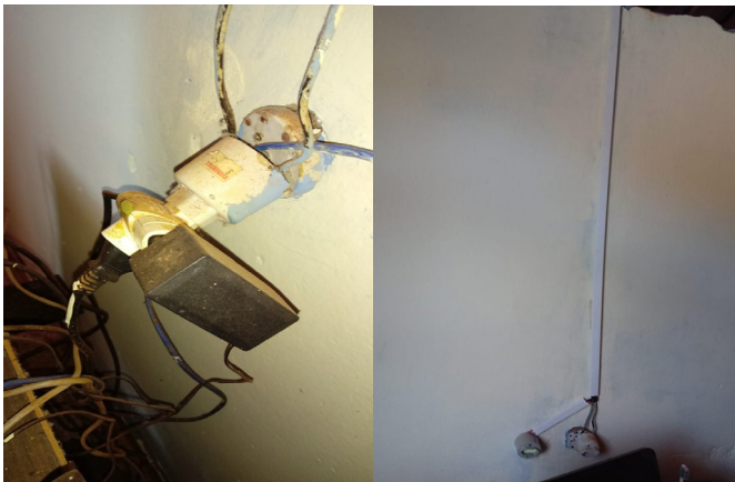
Figs. 19 e 20: Antes e depois de instalação na qual foi adicionada uma tomada à já existente como solução para a sobrecarga.
