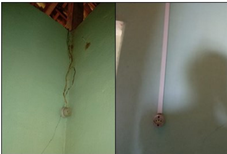
Figura 16: Antes e depois de instalação na qual foram trocados os fios e a tomada e adicionada a canaleta.
