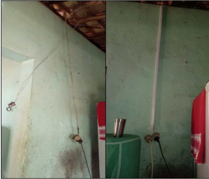
Figura 18: Antes e depois de instalação trocada, mostrando visivelmente uma melhora na estética e na segurança contra choques elétricos por contato direto.
