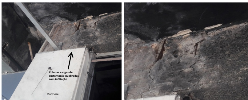
Figura 12 – Esmagamento da viga principal devido à sobrecarga
