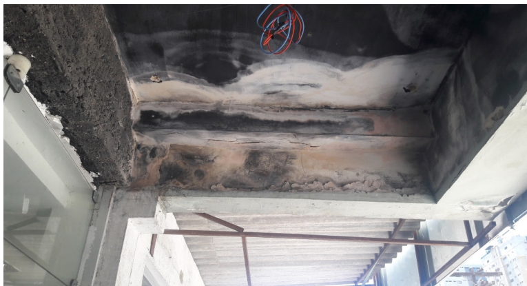
Figura 13 – Bolor e mancha de umidade
