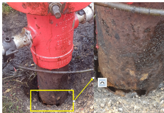
Figura 3: Revestimento de produção rasgado por corrosão
