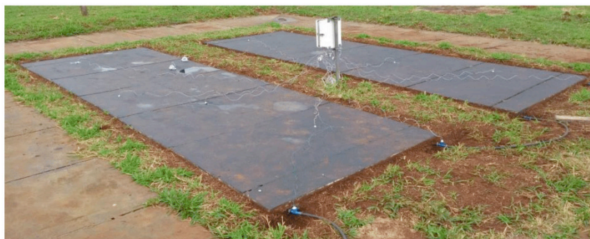
Figura 4 - Coletor Solar de Concreto em Operação.
