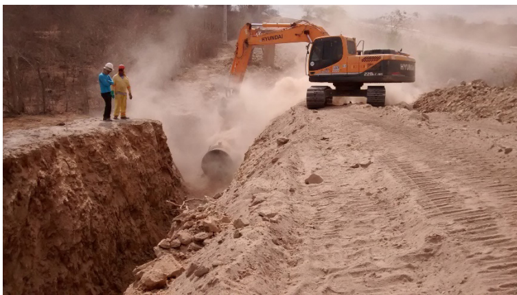
Figura 4 - Poluição visual na escavação tradicional da adutora do agreste
