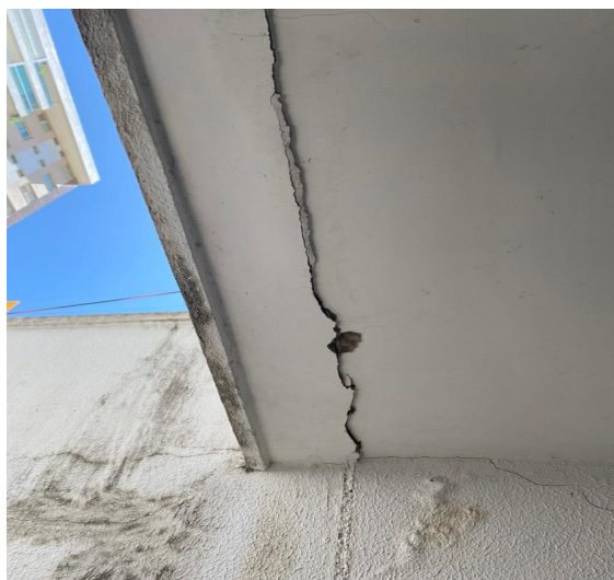
Figura 2- Rachadura no teto da área administrativa.
