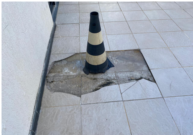
Figura 3- Deslocamento cerâmico nas áreas de circulação comum.
