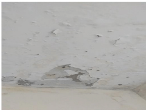
Figura 6- Infiltração causada pela água da chuva no teto da administração do condomínio
