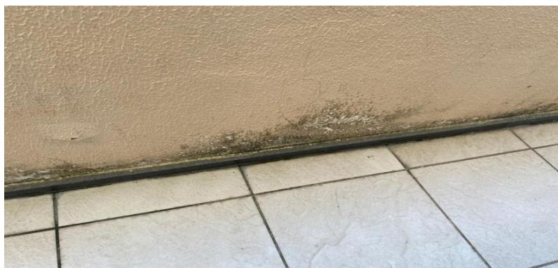
Figura 5- Capilaridades no rodapé da parede do apartamento.
