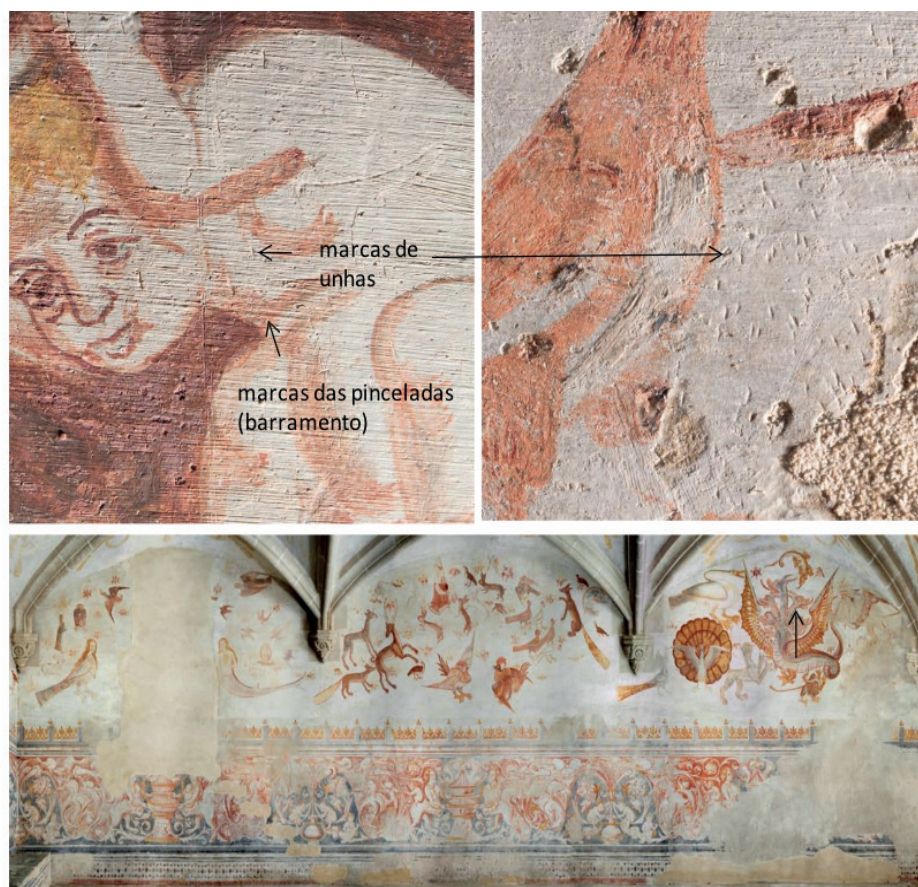
Fig.1. Casas Pintadas : vista geral das pinturas murais na parede da galeria e dois pormenores em luz Visível-rasante onde é possível observar as marcas das pinceladas e de marcas de unhas (foto MGil012). Dimensões da pintura: 10.3mx3.2m.
