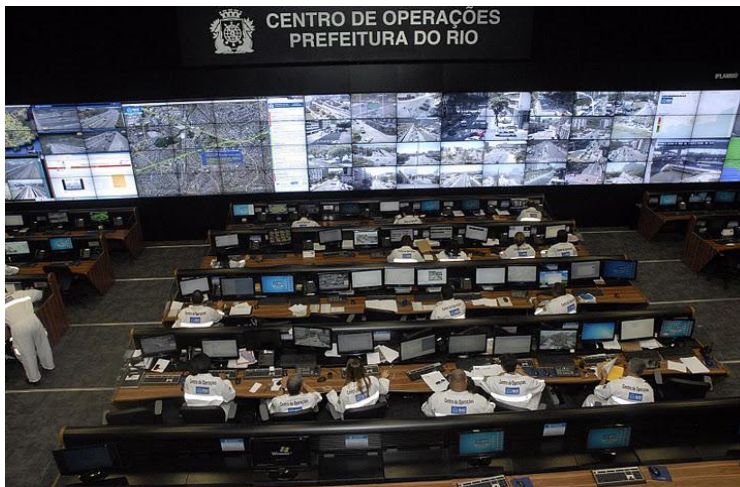
Figura 2: Sala de Controle do Centro de Operações Rio (Fonte: COR/PCRJ)
