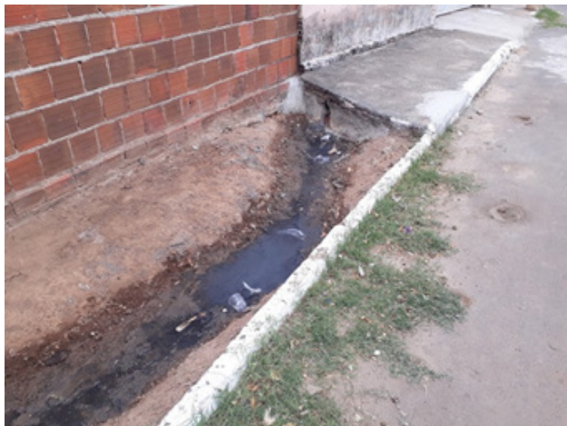
Figura 4 - Esgoto a céu aberto
