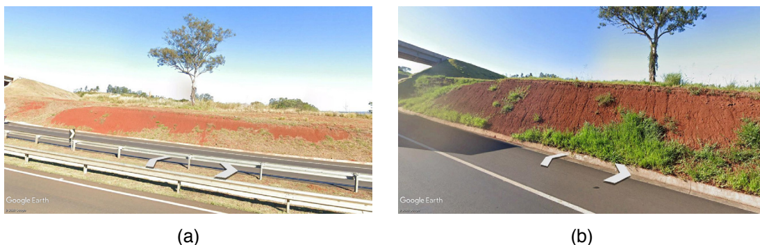
Figura 13 – (a) Talude terroso no trecho estudado da BR-376 km 244+310 LD (b) presença de pequenos sulcos na face do talude.
