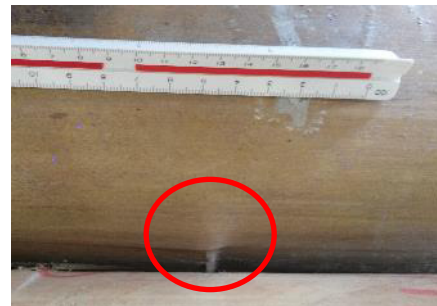
Figura 16 - Descolamento local do bambu no centro da laje. Fonte: Elaborado pelos autores.
