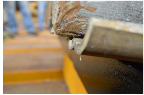
Figura 21 - Deslizamento do concreto nos apoios. Fonte: Elaborado pelos autores.
