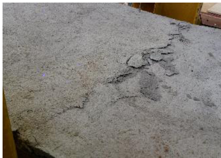
Figura 13 - Ruptura da capa de concreto. Fonte: Elaborado pelos autores.
