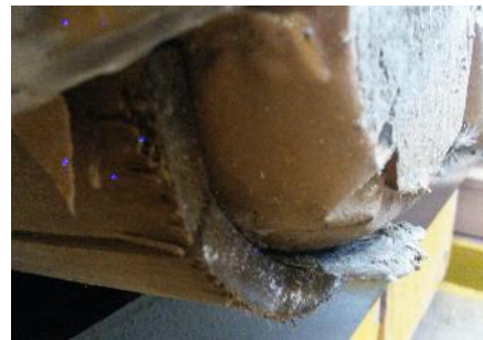
Figura 14 - Deslizamento da massa de concreto no apoio. Fonte: Elaborado pelos autores.
