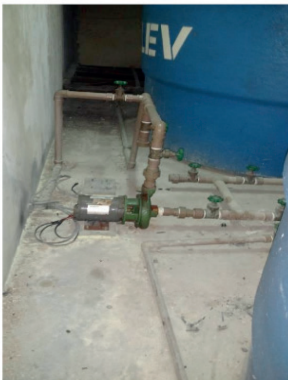
Figura 6 – Bomba de água, encanamentos e reservatórios.
