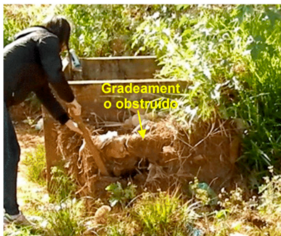
Figura 17 – Obstrução do gradeamento do orifício de fundo da estrutura de saída d'água
