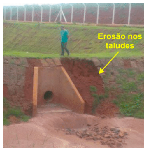
Figura 14 – Erosão nos taludes (Exemplo 2)
