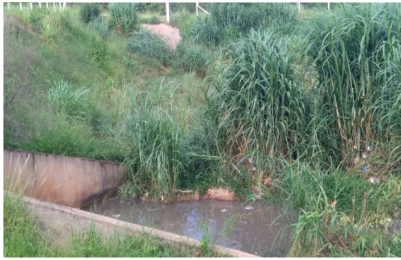
Figura 15 – Acúmulo de água e excesso de vegetação
