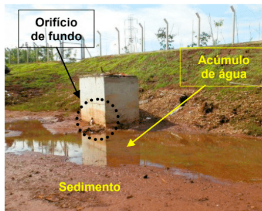
Figura 12 – Acúmulo de água antes da Erosão nos taludes internos da BD
