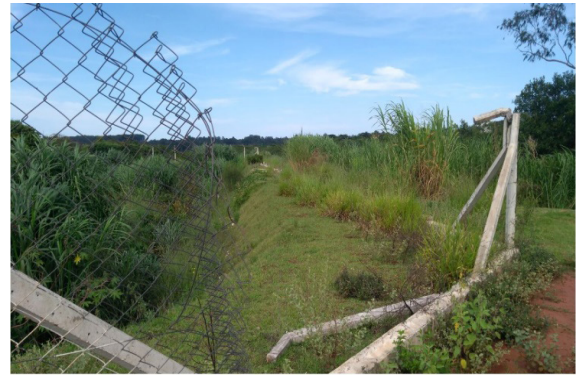
Figura 16 – Depredação do alambrado
