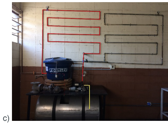
(Figura 7- Bancada Hidráulica 1 “caso c”)
