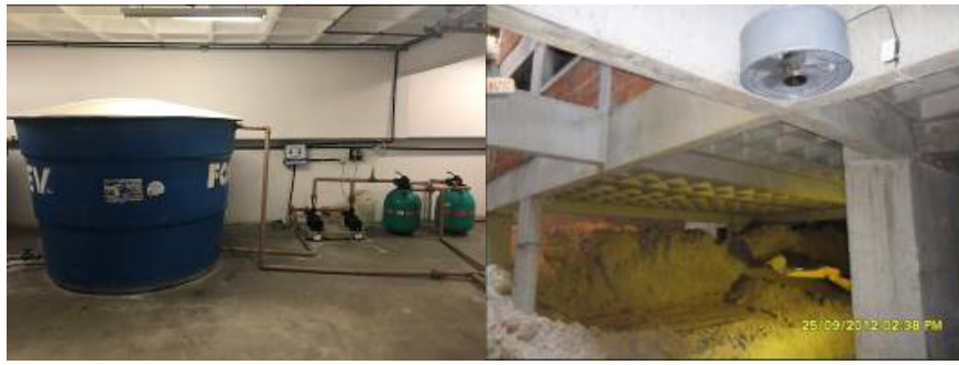
Figura 6- Estação das águas pluviais e Exaustor no subsolo
