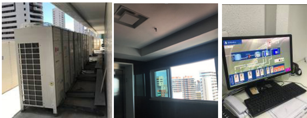
Figura 7 -Sistema de ar condicionado, iluminação led, elevadores e automação
