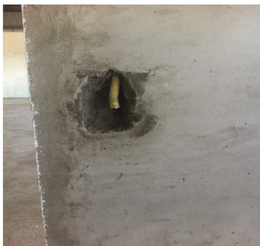
Figura 3 - Perda de materiais nos pontos de energia (CORREIA et al. (2017))
