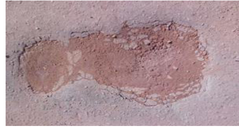
Figura 8 – Buraco “Panela” com Erosão nas Bordas – Rua Sebastião Queiroz (Autores (2018))
