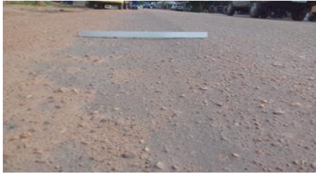
Figura 7 – Afundamento Plástico Local – Rua Vereador Júlio Pinto Pereira (Autores (2018))
