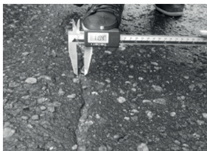
Figura 1 – Fenda do tipo trinca - Av. Procópio Rola (Autores (2018))
