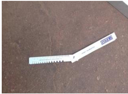
Figura 13 – Fissuras – Rua Pedro Siqueira Um (Autores (2018))
