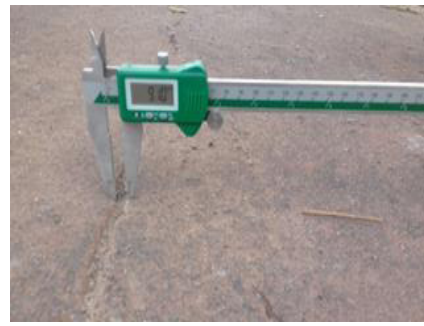
Figura 14 – Trinca – Rua Pedro Siqueira Um (Autores (2018))
