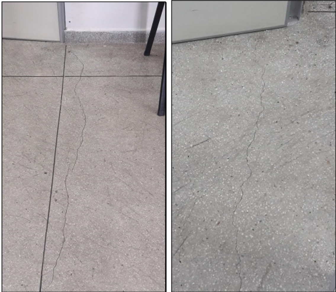
Figura 4 - Fissuras na Laje Superior / piso.
