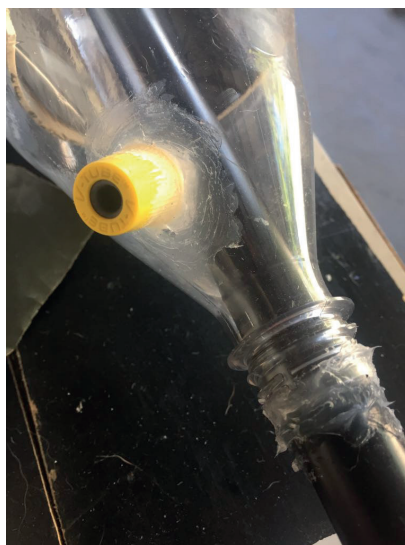
Figura 9: Válvula de vácuo em um dos coletores.
