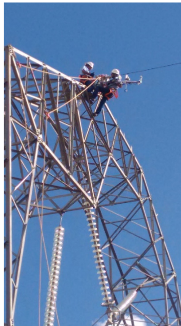
Figura 6: Teste na linha desenergizada - Pires do Rio.
