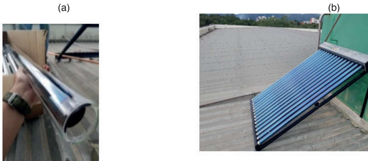
Figura 5 – (a) Tubo à vácuo ; (b) Sistema de aquecimento solar tubular à vácuo instalado.
