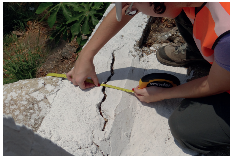
Figura 3 - Ala a jusante do lado sul apresentando fissura
