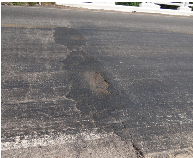
Figura 4 – Desnível na entrada da ponte
