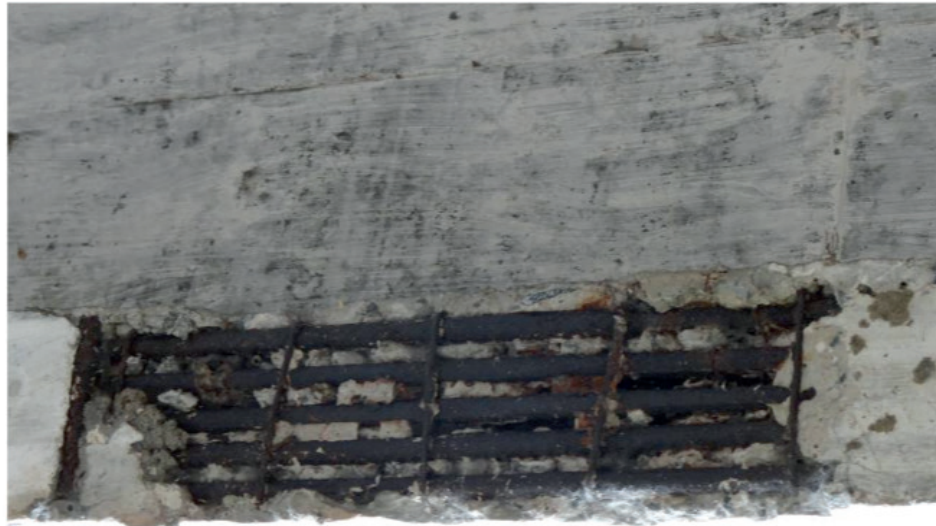
Figura 2 - Longarina com armadura exposta, de nicho de concretagem e corrosão
