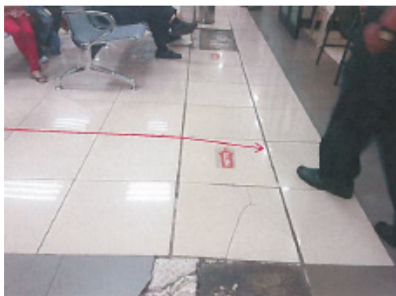
Figura 5: Rachaduras excessivas em pisos.
