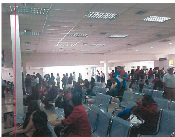
Figura 4: Inclinação de elementos estruturais;
