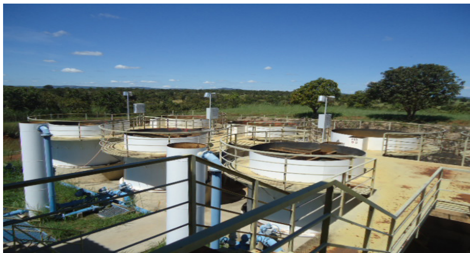
FIGURA 16 – Filtros de Lavagem – ETA 02
