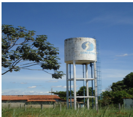
FIGURA 19 – Reservatório REL localizado na ETA 02
