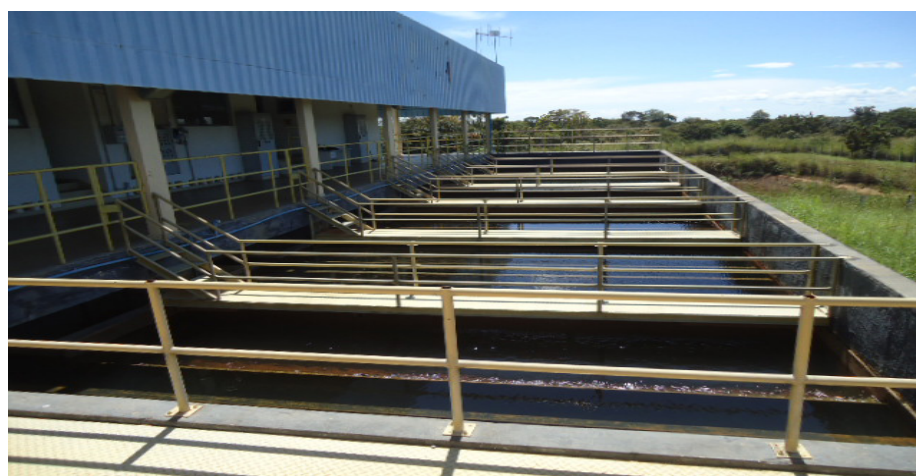
FIGURA 17 – Conjunto de Filtros – Dupla filtração
