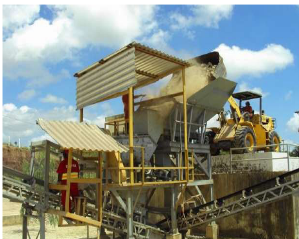
Figura 5. Britador de RCC
